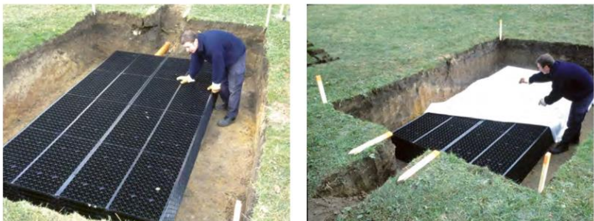
Abb. 18: Einsetzen der Kunststoffelemente (Quelle: Regenwasserversickerung – Gestaltung von Wegen und Plätzen Praxisratgeber für den Grundstückseigentümer (Bayerisches Landesamt für Umwelt))
