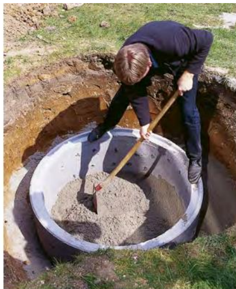
Abb. 22: Bau eines Sickerschachtes (Quelle: Regenwasserversickerung – Gestaltung von Wegen und Plätzen Praxisratgeber für den Grundstückseigentümer (Bayerisches Landesamt für Umwelt))
